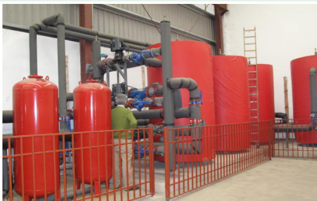
Sección de acumuladores y SAES.
