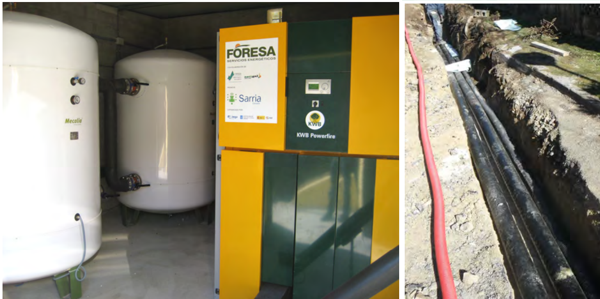
Sala de calderas y tendido de tubería preaislada.
