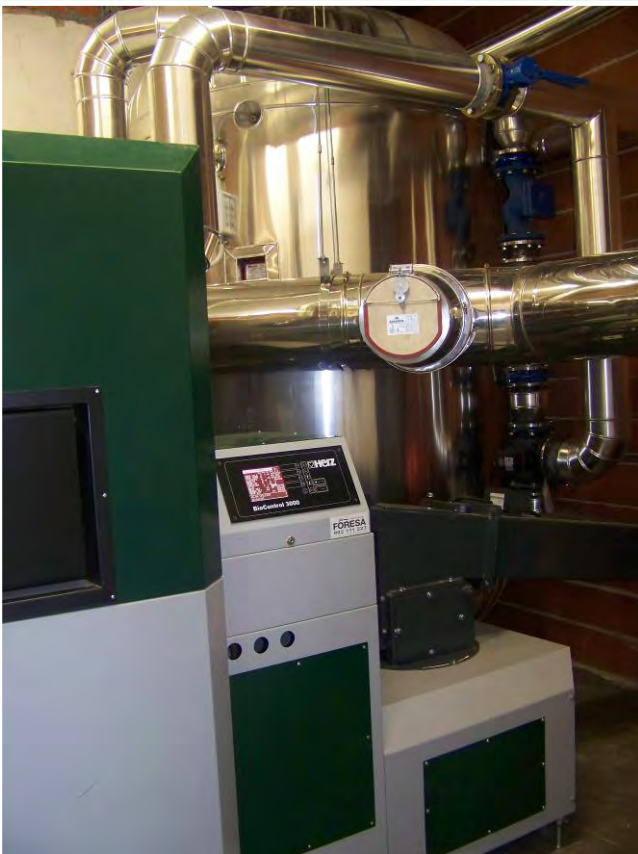
Sala de calderas
