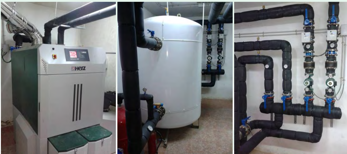
Caldera, depósito de acumulación y bombas.
