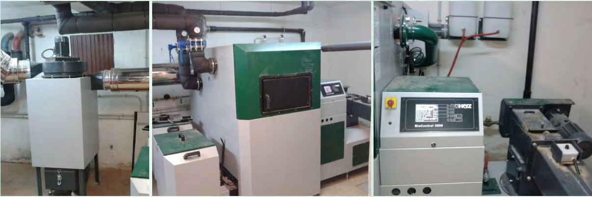
Izq: Ciclón. Centro: Depósito de cenizas de combustión y caldera. Dcha: Centro de control y alimentador de pellet.
