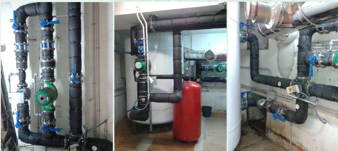
Detalles de bombas, contador, válvulas, depósito de inercia y de expansión.
